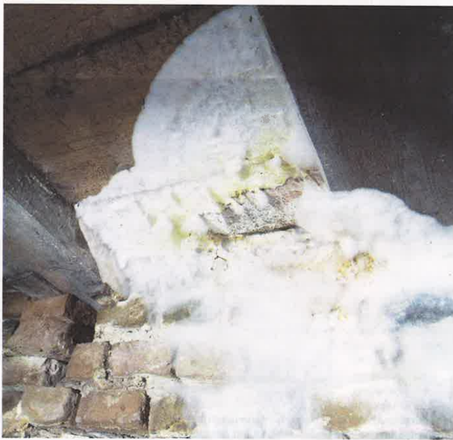
Jong weefsel van huiszwam in kruipruimte onder (lekkende) badkamer
