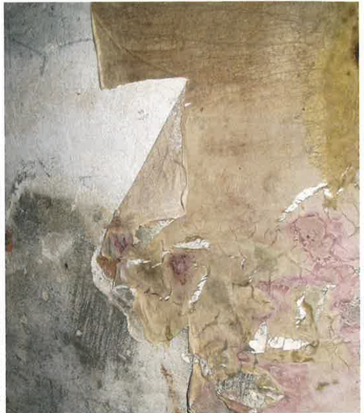
Deels loshangend vlies van huiszwam op een kelderwand. Foto: SHR
