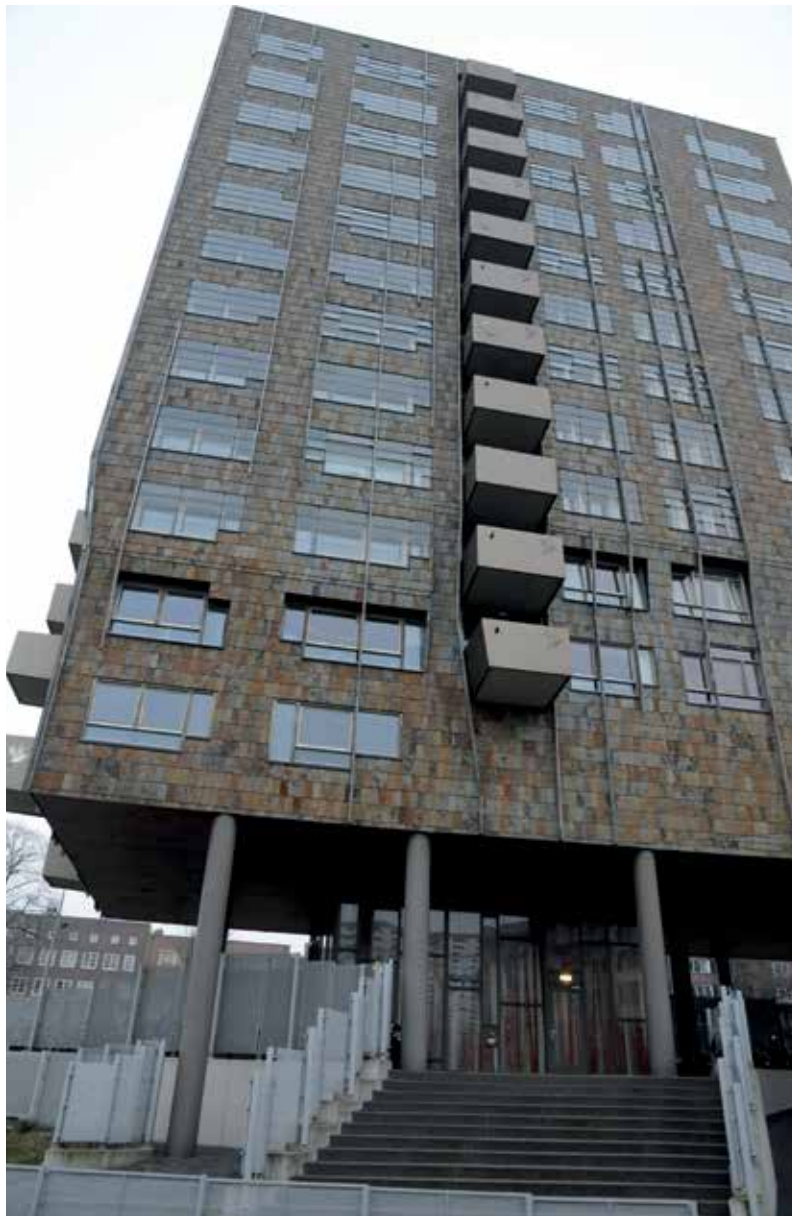
ONAFGEWERKTE KOZIJNEN, TWEELINGGEBOUW, AMSTERDAM.
