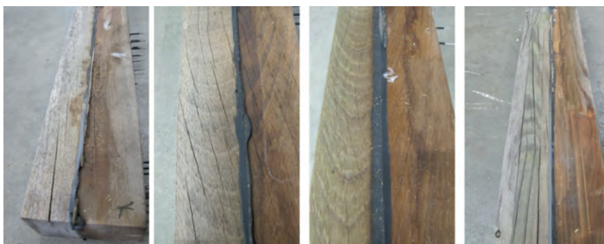
Scheurvorming. Linkerzijde is geëxposeerde en rechterzijde de beschutte zijde. V.l.n.r. sapeli, jatoba, guariuba en lariks.
