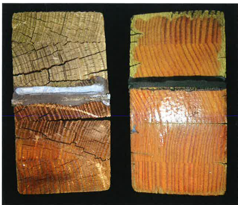
Invloed van kopsse afdichting op scheurvorming: onafgewerkt lariks links zonder kopsse afdichting en rechts met kopsse afdichting; boven kitnaad geëxposeerde en onder kitnaad beschutte zijde
